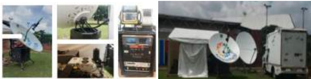
Sistema de Enlaces satelital y respaldo instalado
